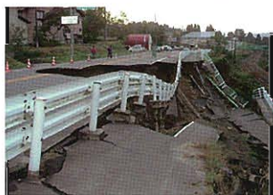
被災状況(H16.10.24)
