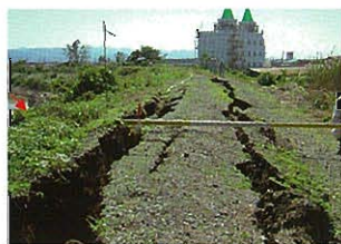
被災状況(H16.10.24)
