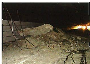
被災状況(H16.10.24)
