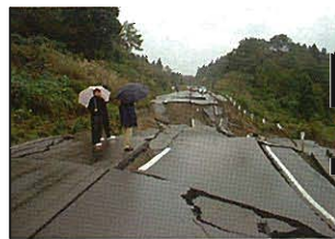
被災状況(H16.10.26)
