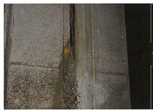
被災状況(水処理施設の漏水,H16.10.25)
