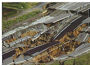
被災状況(H16.10.24)
