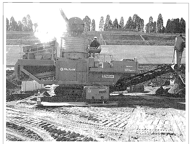
写真一1 自走式混練プラント
