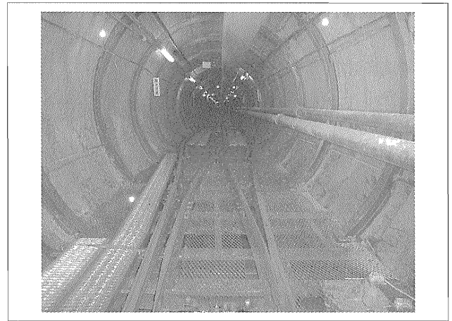
写真-6 坑内の離合部 (浜ノ瀬幹線)
