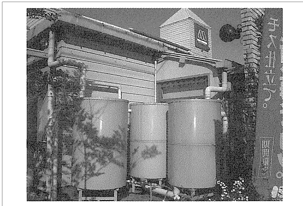
写真-8 モスバーガー川越山田店の中水利用システム
