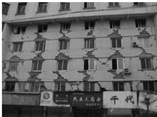
写真—3 建物壁のせん断破壊 (綿竹市)
