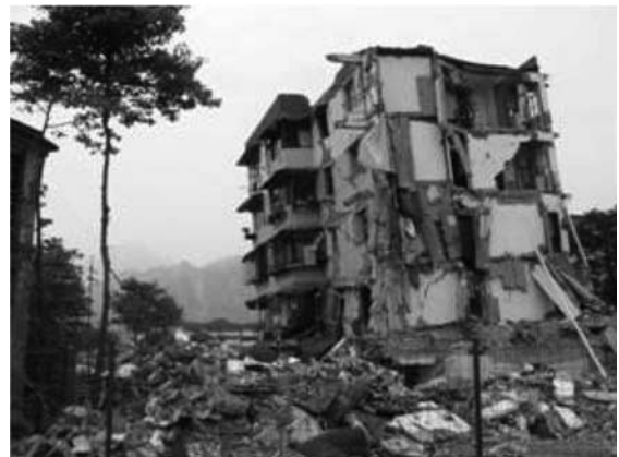
写真—2 倒壊した建物（漢旺鎮）
