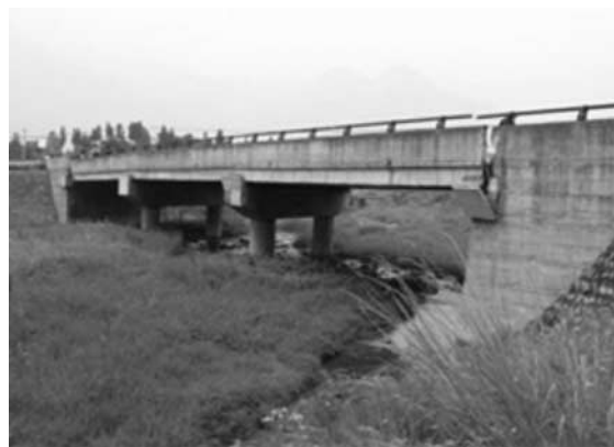
写真—5 橋梁(盆地部)の被害例 (綿竹市) (上部工の手前が左方向，奥が右方向に回転)
