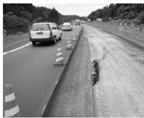
写真-8 舗装路盤の空洞・亀裂
