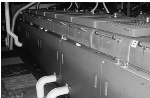
写真－2 クリーンルーム内のステンレス腐食
