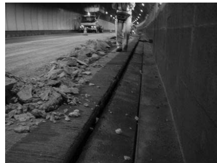
写真—16 覆工コンクリートはく落状況
