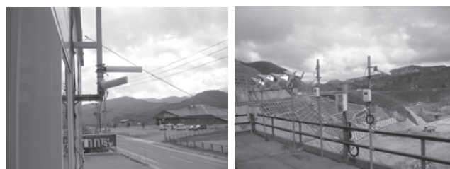
(1) 試験室側アンテナ施設 (2) 中継局アンテナ施設 写真—1 無線LANシステムの中継局
