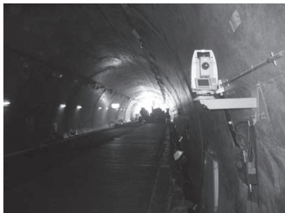
写真—11 トータルステーション設置状況
