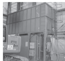
写真—1 エコグラウトプラント
