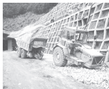
写真-2 ダンプトラックでの事故発生状況
