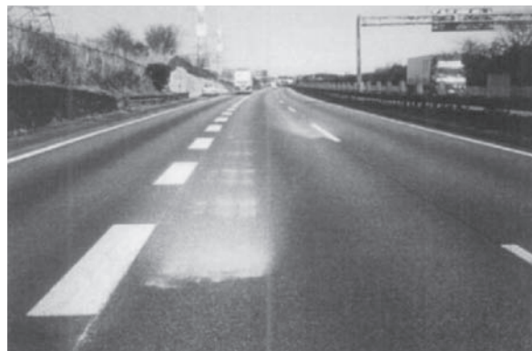
写真—2 内部損傷の例（ボンピング）
