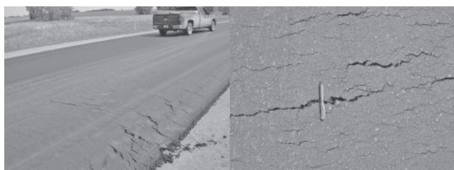
写真-3 CCVの低い路盤上に施工されたアスファルト層の破壊
