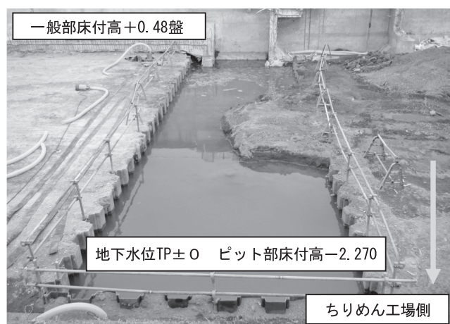
写真—2 水処理施設ピット部水位状況
