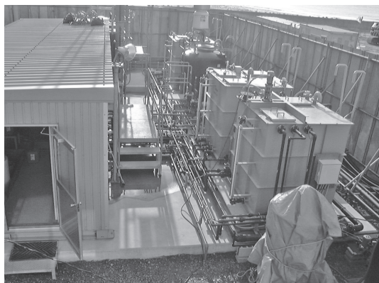
写真—2 実証試験プラント 全景
