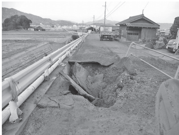
写真—3 パイプラインからの漏水による道路陥没
