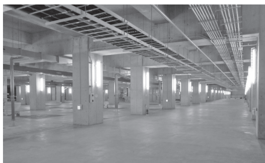
写真一 供用中の水処理施設内部
