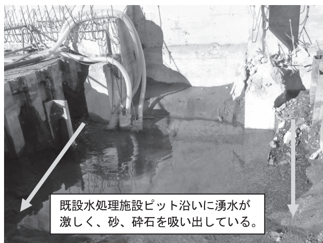
写真—3 水処理施設ピット部湧水状況
