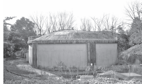
写真—15 改修前の配水池
