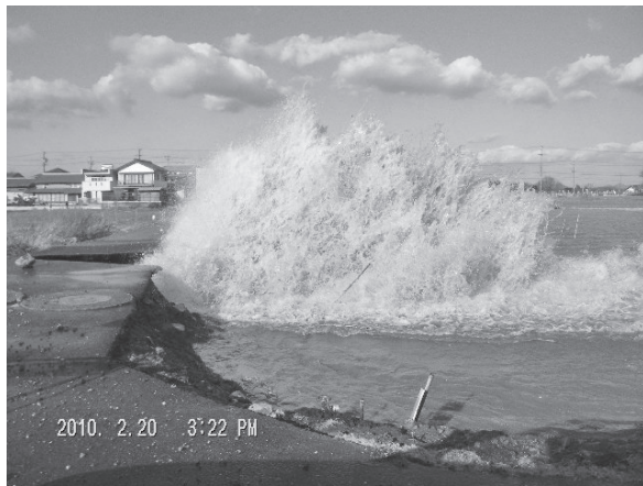
写真—2 パイプラインの破裂による農地浸水
