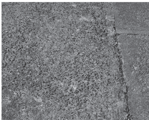
写真—1 摩耗して骨材が浮き出ている水路壁
