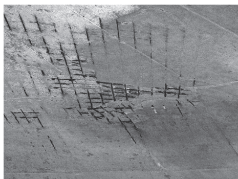
写真—1 RC ドーム内面の劣化
