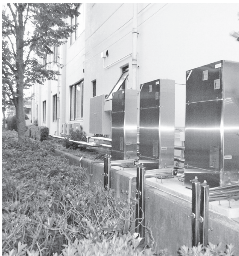
写真—3 地中熱ヒートポンプ（10 kW × 3台） 春日部市役所
