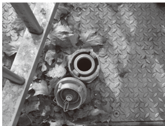
写真—11 樋洗浄用の注水口 (スイス)
