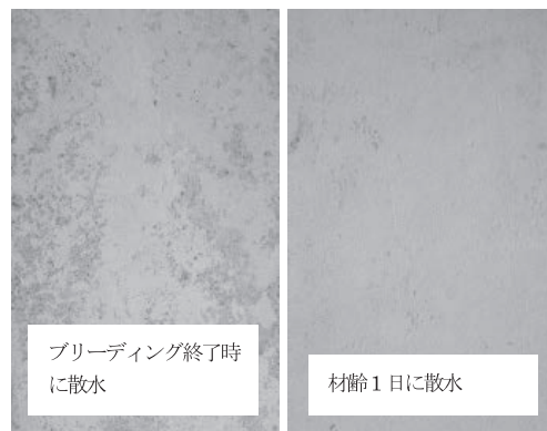
写真—1 湛水（散水）時期によるコンクリート表面の美観の違い
