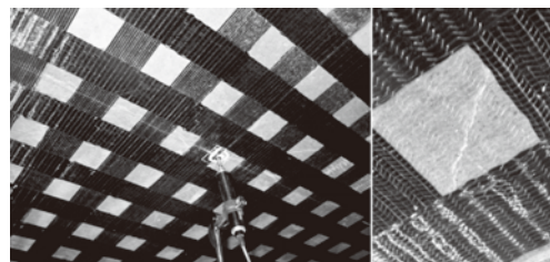
写真－8 ひび割れ視認性
