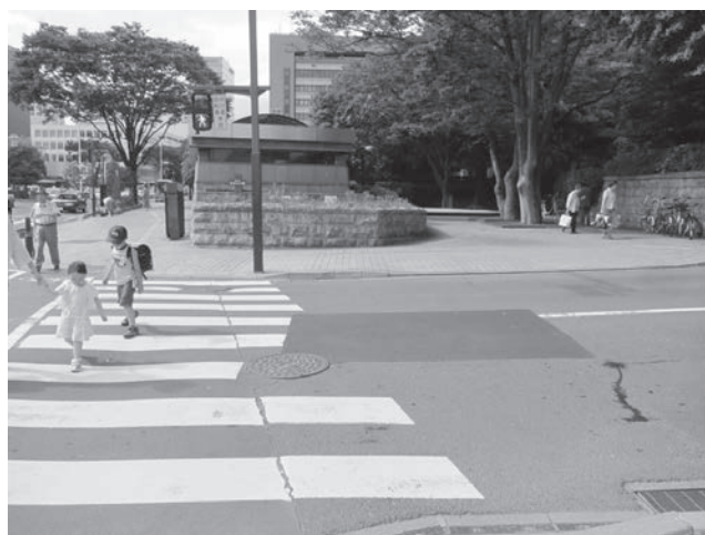
写真―1 傷んだ道路（路面沈下補修後）
