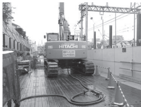
写真—4 電動クラム配線状況
