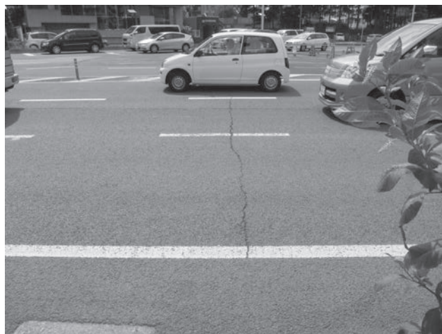
写真―2 傷んだ道路（路面に発生したクラック）
