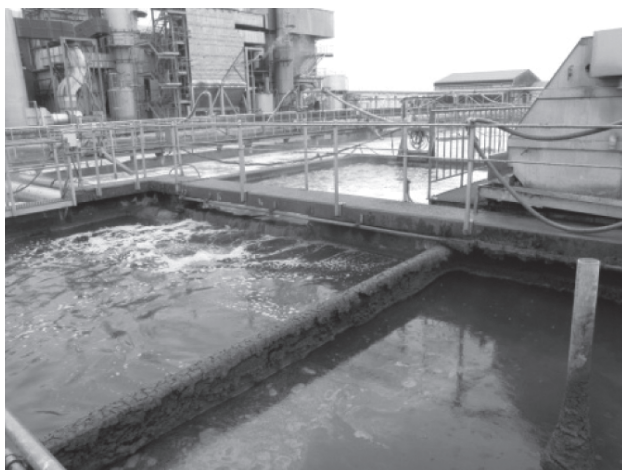
写真一 1 活性汚泥法処理施設
