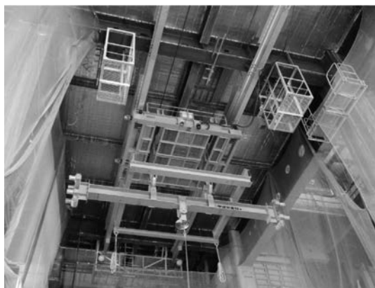
写真—1 25t吊テルハ（トロリー他全景）
