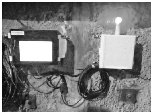
写真—5 LED による警報システム
