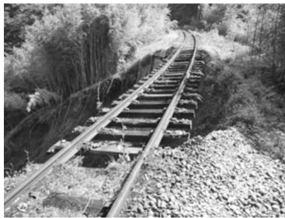
写真一3 被災状況（上方から）
