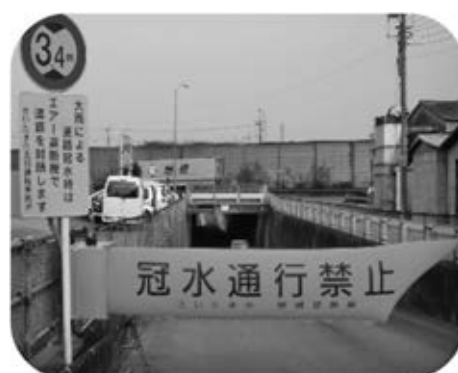
写真—7 エアー式自動交通遮断機
