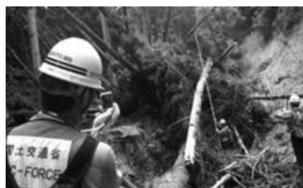
土砂災害危険箇所の被害状況調査
