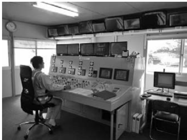
写真—10 設備運転状況（操作室）
