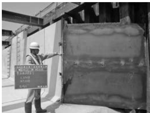
写真—8 擦り付け整流板
