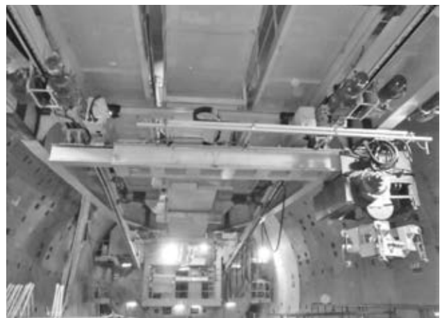
写真—4 後続台車天井クレーン
