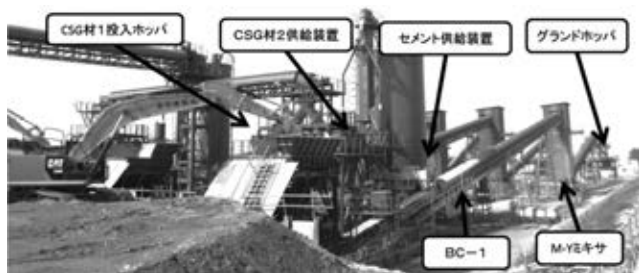
図一 4 CSG 製造設備概要
