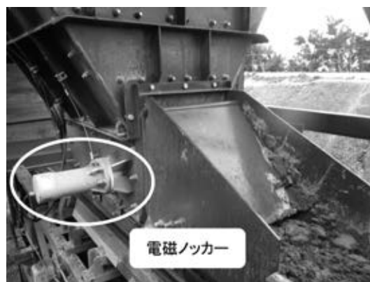
図—9 CSG 材1 投入ホッパ下部
