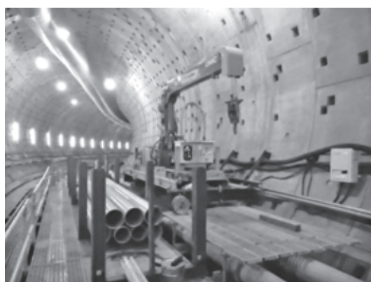
写真－6 坑内資材置き場
