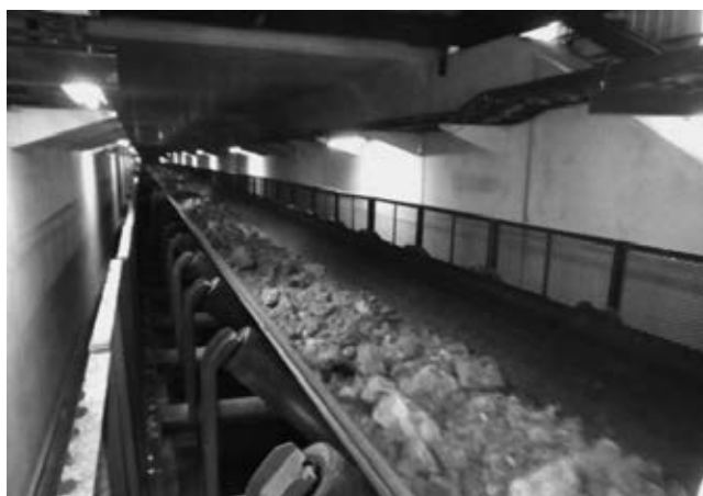
写真一7 ボックスカルバート内のベルトコンベヤ
