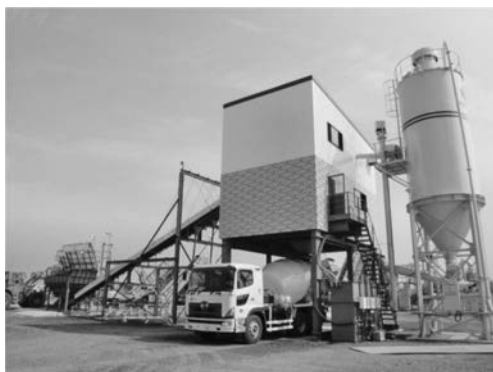
写真—5 バッチャープラント
