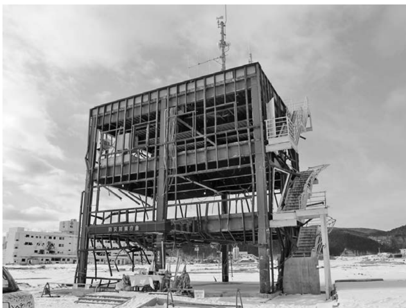
写真一 4 南三陸町の防災対策庁舎（2012年2月 筆者撮影）
