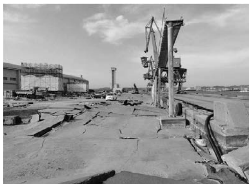
写真—3 小名浜港 3 号埠頭 3-2 岸壁における被災状況
