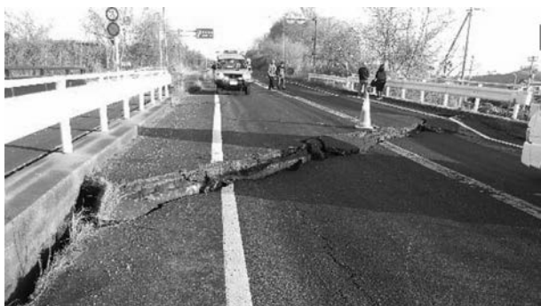
写真—1 東北地方太平洋沖地震の被災状況 1)
