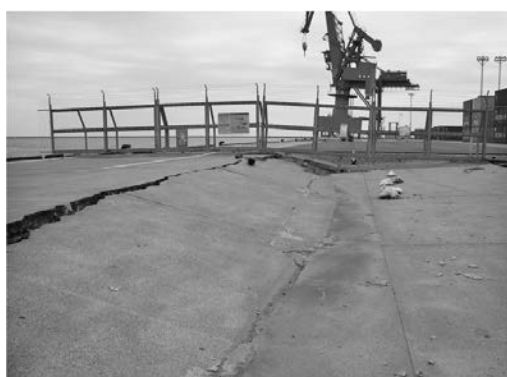
写真—4 小名浜港大剣埠頭岸壁（－7.5 m）被災状況
