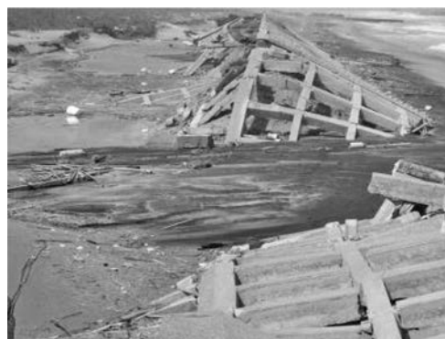
写真—1 浸食により破壊に至った堤防
