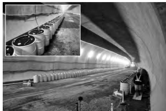
写真—1 トンネル坑内への設置状況
