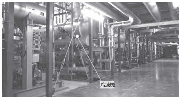
写真—4 凍結プラント建屋内の冷凍機
