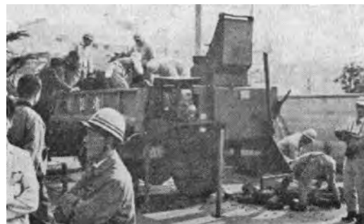
写真 3-23 富士物産製 HM-1A 型 ヒータ・ミックス（廃材再生用） バーナによる加熱装置および1軸式ミキサを装備 合材再生能力：約 1 t/h
