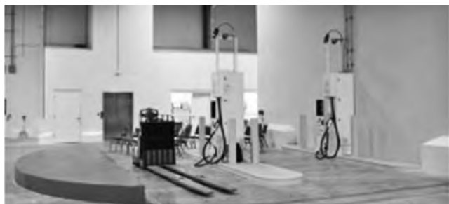
写真一2 北米での屋内水素充てん設備例
