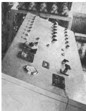
写真 3-20 NAP-15AZV アスファルトプラント自動操作盤 (日本工具製作㈱)
