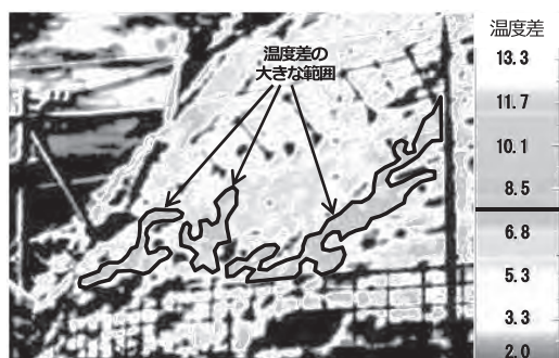
図—6 吹付のり面における事例
