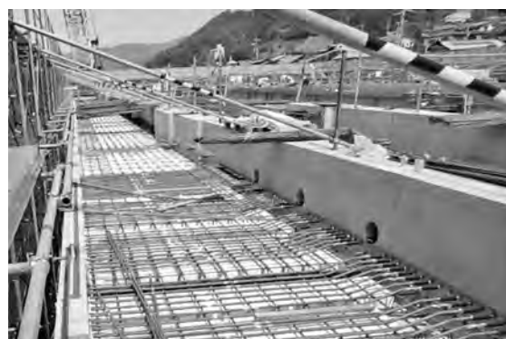
写真-10 PCaPC 梁側面の定着筋
