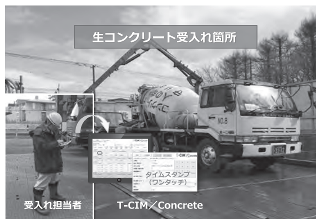
写真ー2 受入れ担当者による運用状況 (本システムの受入れ, 荷卸し)
