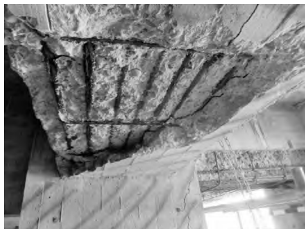
写真—1 塩害劣化を受けた構造物
