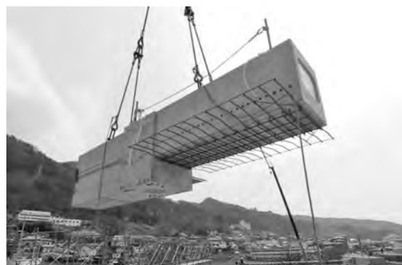
写真-8 PCaPC 梁下の定着筋
