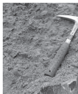
モルタルの土砂化
