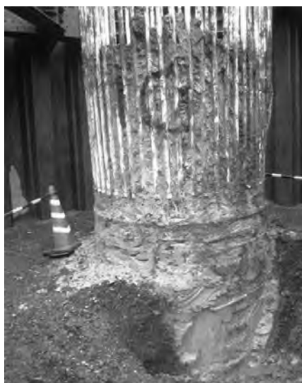
写真—1 場所打ち杭における未充填箇所発生状況
