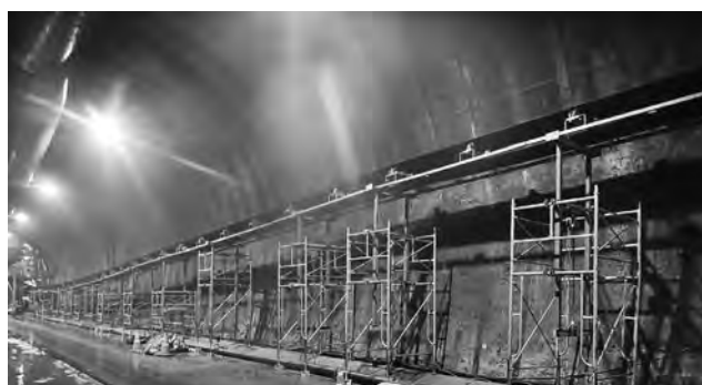
写真—1 連続ベルトコンベア昇降装置 設置状況
