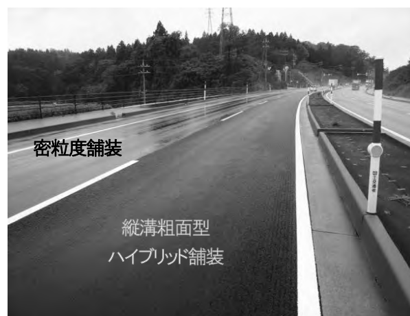
写真—4 縦溝粗面型ハイブリッド舗装浮き水抑制例
