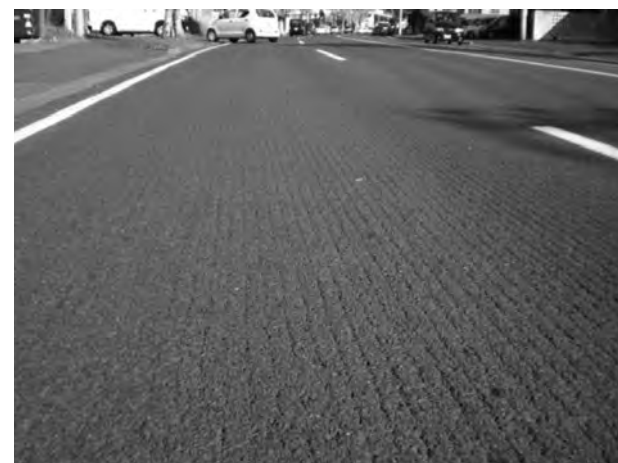
写真—10 25ヶ月後路面状況
