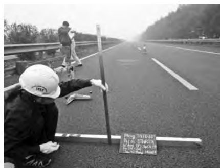
写真—7 わだち掘れ調査
