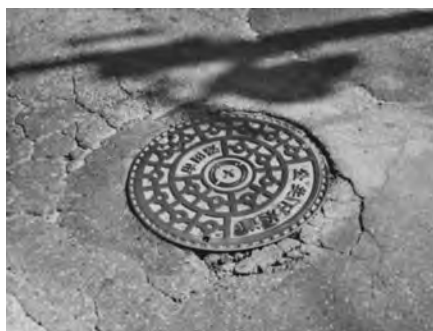
写真—2 マンホールふた周辺舗装の沈下と破損
