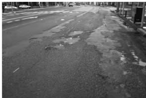
写真-2 排水性舗装の内部破損例
