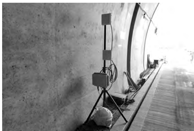
写真ー4 可搬型屋外設置用 Wi-Fi 装置
