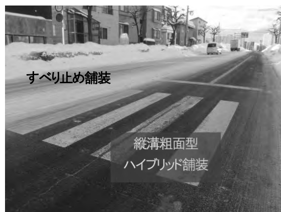
写真—7 41ヶ月後路面露出状況
