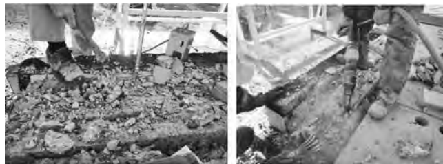
写真-5 後打ちコンクリートの加熱部の破碎
