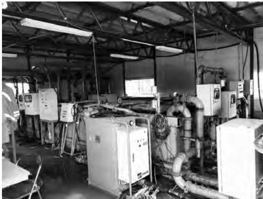
写真—11 放流設備内状況（処理水をポンプにて移送）
