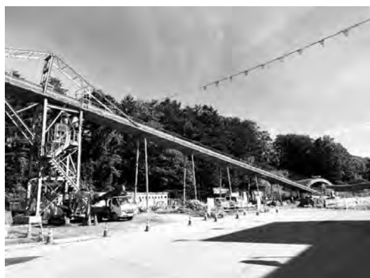
写真二 坑外ベルトコンベヤ（90 m）
