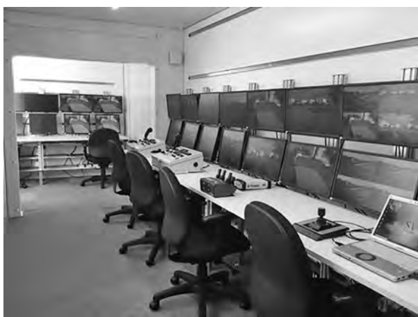
写真一4 拡張型高機能遠隔操作室内部設備
