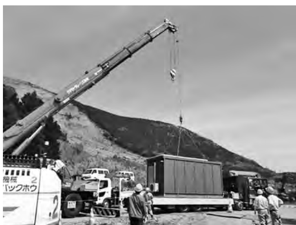
写真—2 阿蘇での高機能遠隔操作室設置状況
