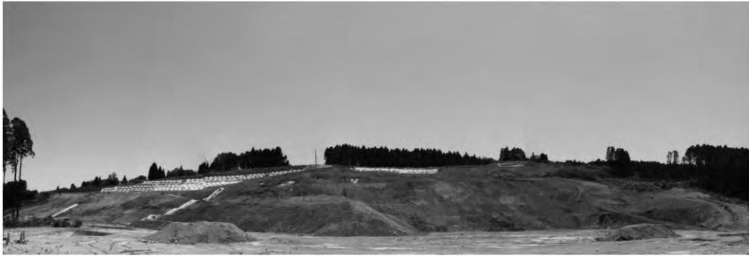
本システムの設置状況
