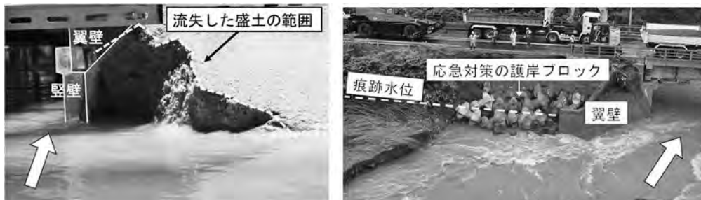
図—11 実験①と実橋台での被災事例の比較
