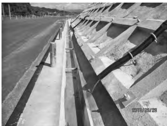
写真一 晴天時の排水状況
