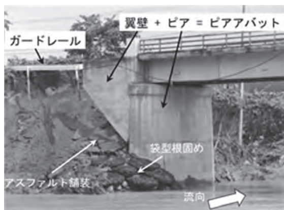
図-3 ピアアバット形式橋台の被災事例
