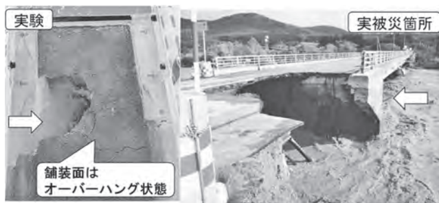
図-2 先行実験結果と実橋台での被災事例の比較
