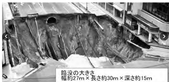
図—1 福岡市交通局七隈線延伸工事現場における道路陥没（平成 28 年 11 月）
