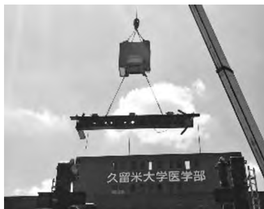
写真-15 吊荷旋回制御装置の現場使用状況
