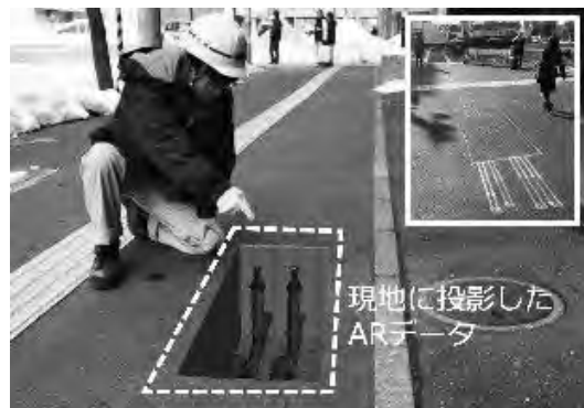
写真ー11 埋設管をARで表現
