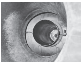
図-16 二重構造の排気管の例
