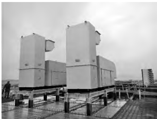
写真—4 設備架台
