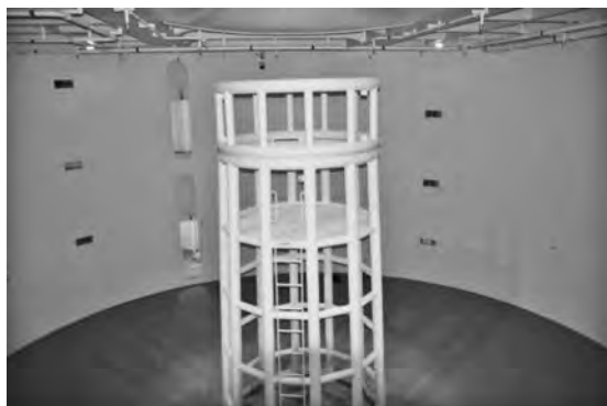
写真—1 ケーブルタンク
