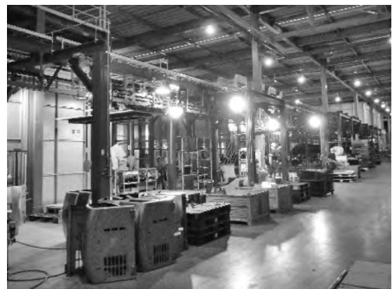
写真—5 塗装設備
