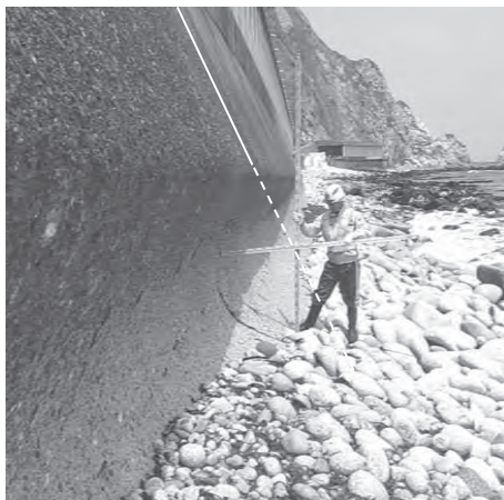
写真—2 海岸擁壁の浸食（黄金道路）
