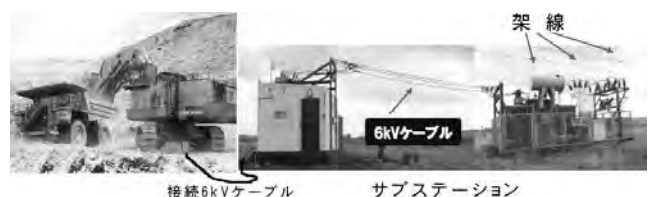
写真—18 給電設備
