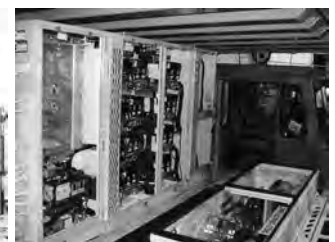
写真—34 コントロールキャビネット
