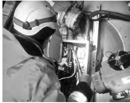
写真一九 風車単基引渡し検査（ハブ内）
