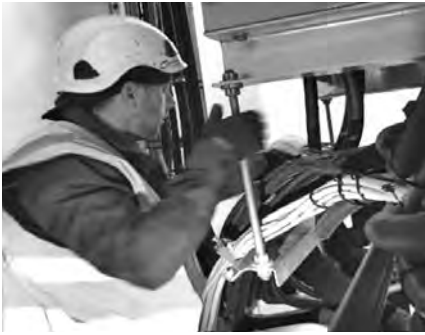
写真一八 風車単基引渡し検査（変圧器室）
