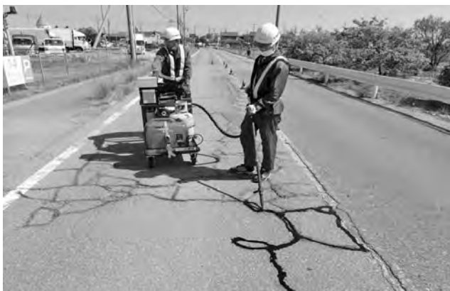
写真一3 アスファルト目地注入機を用いた舗装クラック注入状況
