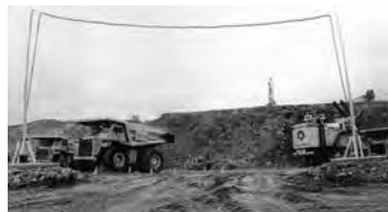
写真一4 移動式ケーブルタワー
