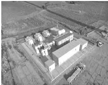
写真一一 変電所
