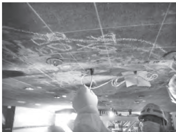
写真—1 チタンワイヤセンサーの設置状況
