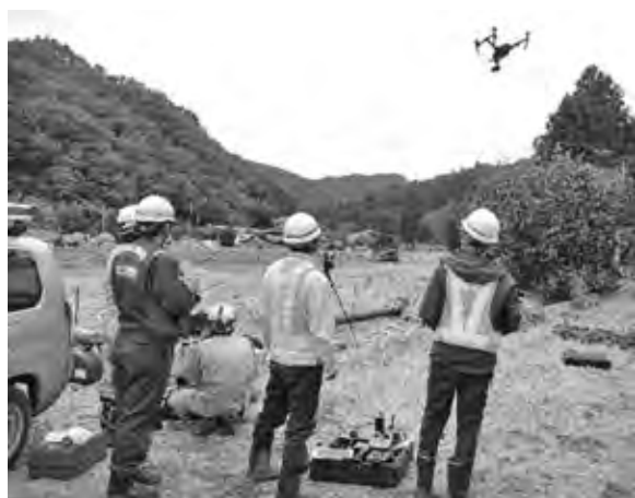
写真—11 ドローンを活用した被災状況調査（宮城県丸森町）
