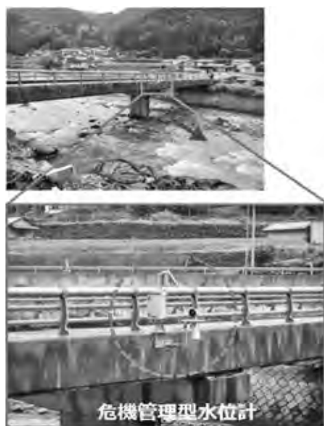
写真一 3 危機管理型水位計設置例
