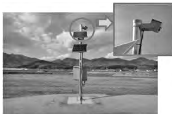
写真一 4 簡易型河川監視カメラ設置例
