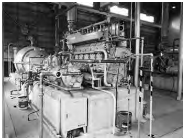
写真－3 主ポンプ駆動用ディーゼル機関（S5排水機場）
