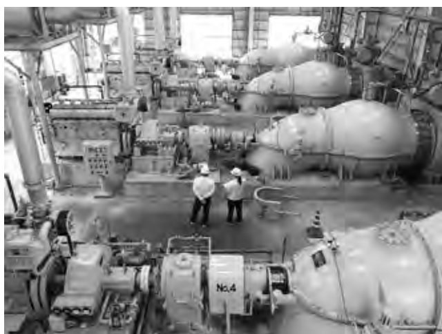
写真-2 ポンプ設備（S5排水機場）
