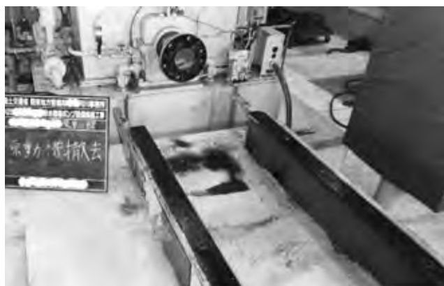
写真－5 ディーゼル機関台盤（S5排水機場）
