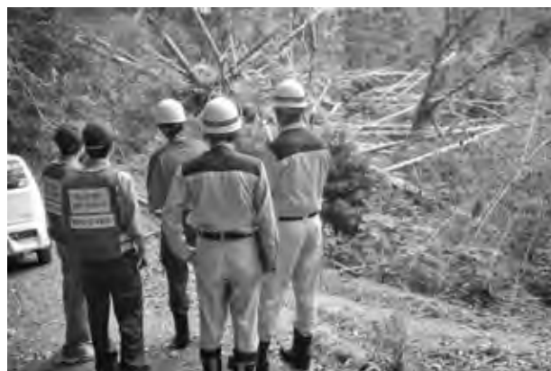
写真—6 送電線復旧のため倒木除去に向けた現地調査（千葉県富津市）
