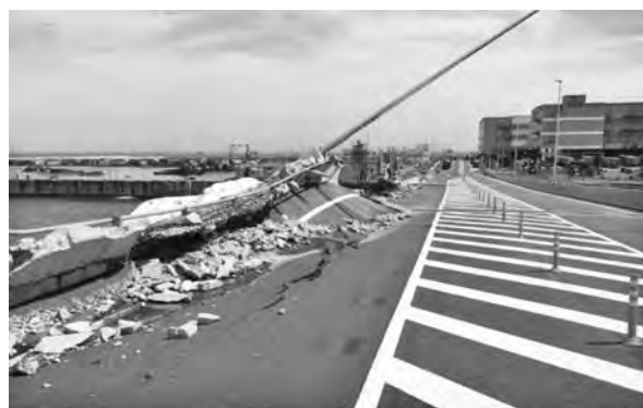
写真—2 横浜港南本牧はま道路への船舶衝突（令和元年房総半島台風）
