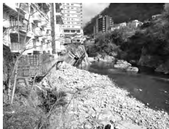
写真—13 損壊した護岸（復旧前）
