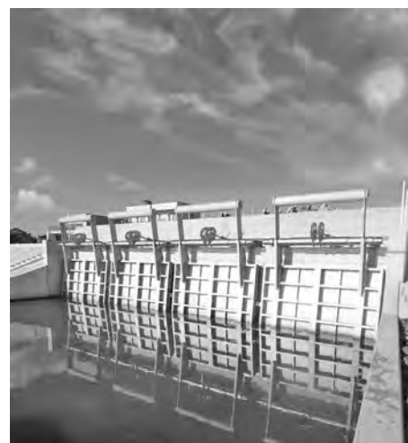
写真—1 設置状況 1（津波対策用ゲート）
