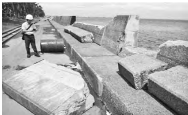
写真—1 横浜港における高波による護岸倒壊（令和元年房総半島台風）
