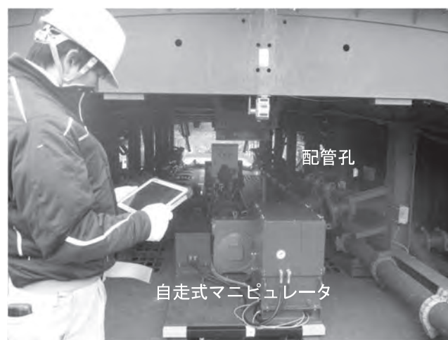
写真—1 システム操作状況
