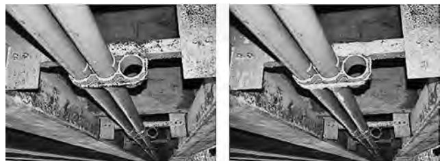
写真—8 画像 AI による損傷抽出例 (錆)
