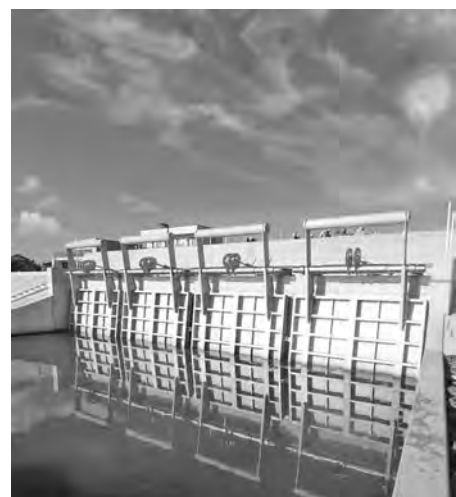
写真—1 設置状況 1（津波対策用ゲート）
