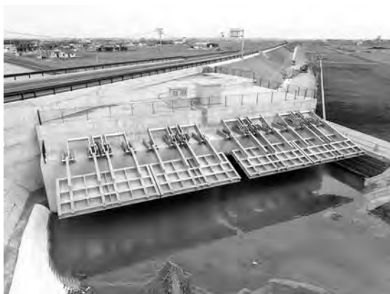
写真-2 設置状況 2 (津波対策用ゲート)
