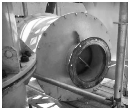
写真—9 消音マフラーのみ
