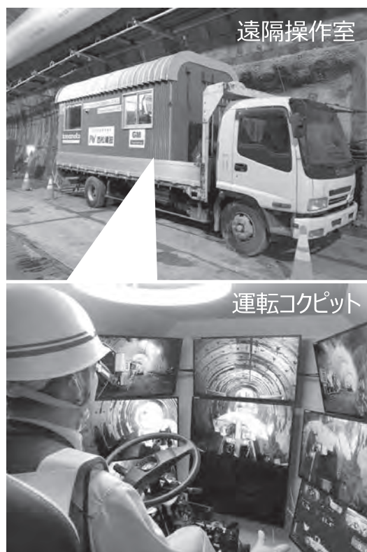
写真-2 遠隔操作室および運転コクピット
