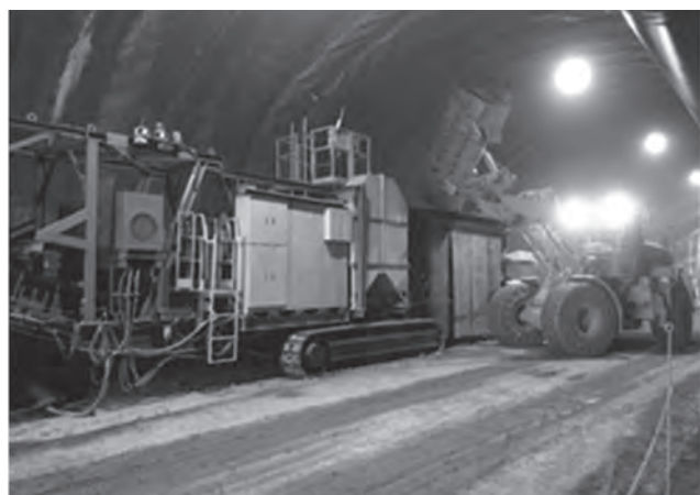
写真1 遠隔操作システム稼働状況
