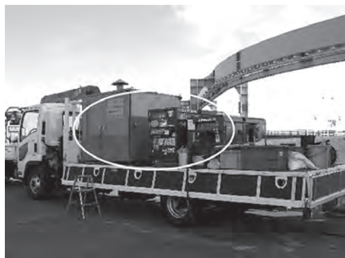
写真一5 油水分離・高圧洗浄ユニット (○印)
