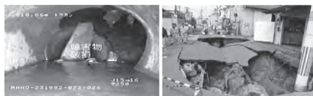
写真－1 道路陥没状況
