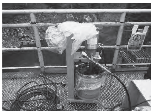
写真—10 給油ポンプ
