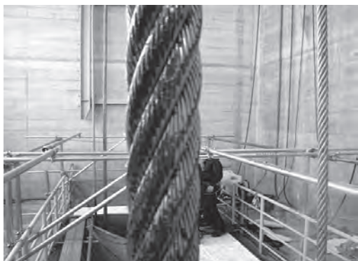
写真13 めっき層の損失状況
