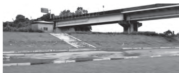
写真—5 水位の痕跡（2020.7.15 撮影）
