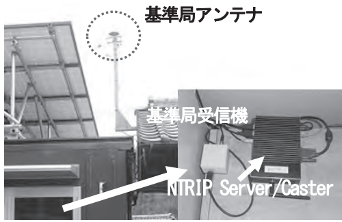
図-12 基準局アンテナとNTRIPサーバー
