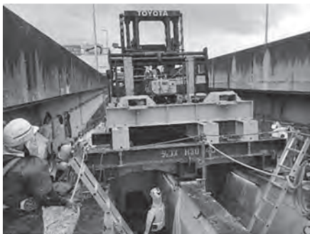
写真-4 床版剥離状況
