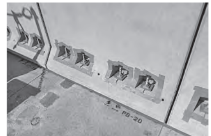
写真-16 PCa 壁高欄のボルトボックス
