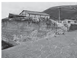
老朽化した海岸堤防
