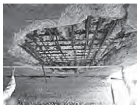
内部の鉄筋が露出した橋梁
