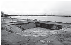
陥没した港湾施設のエプロン部分
