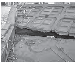
クラックが生じた河川護岸
