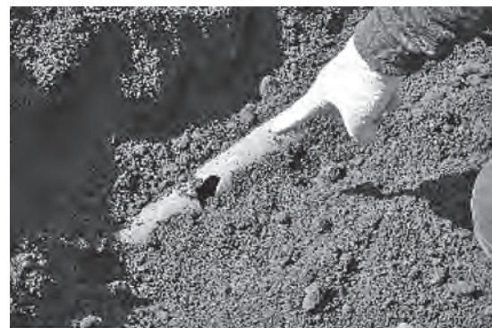
写真—7 従来施工時のバケット接触による破損箇所
