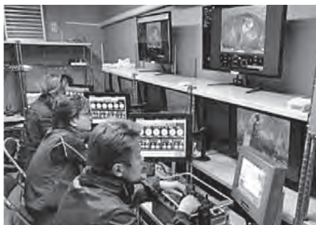
中央制御室からの遠隔操作の状況
