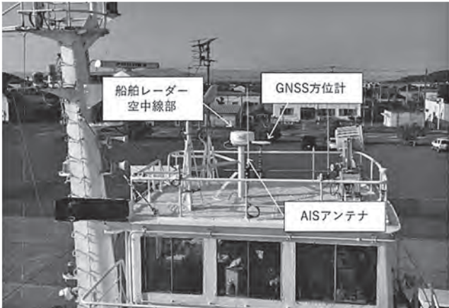
図一14 機器設置状況 (屋外)
