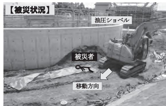
写真-1 油圧ショベルと作業員の接触事故
