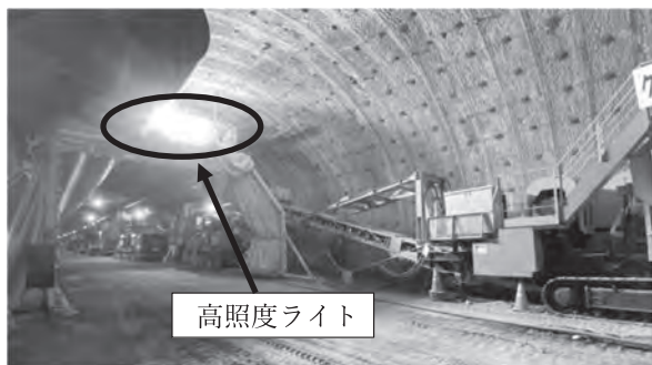
写真-3 照明架台と白色 LED 照明
