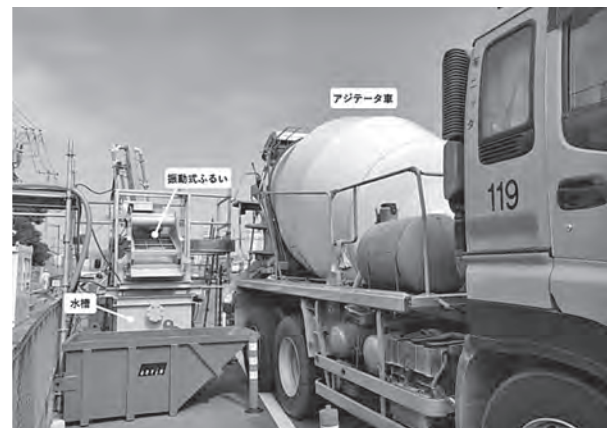
写真一3 アジテータ車からコンクリートを散水装置付き振動ふるいに入れている状況
