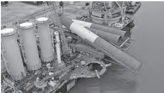
写真一4 作業船甲板に据え付けられた Up-ending Frame 集中荷重となるため、甲板強度の詳細な安全性検討が肝要
