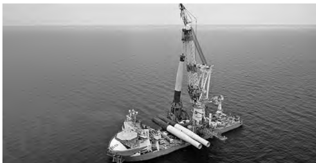
写真—14 M/V “ORION” 作業風景 DPS 付き杭鉛直度維持装置（Dynamic Outrigger）を搭載
