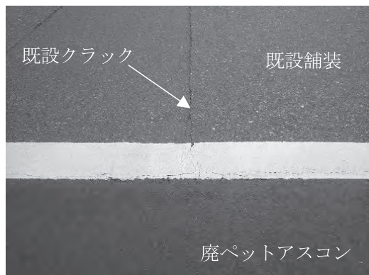
写真一六 既設のクラックとの接続部
