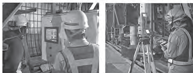
自動セット制御盤での基本操作
