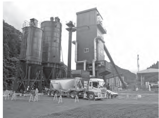
写真一八 コンクリート製造設備
