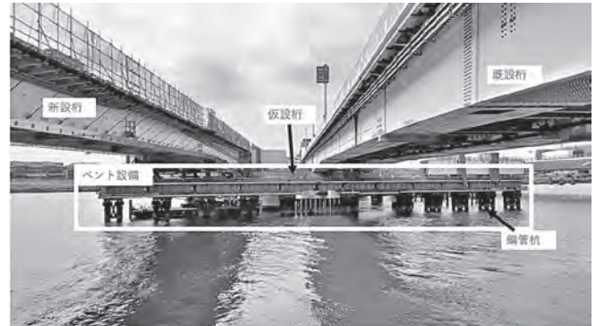
写真-1 ベント設備
