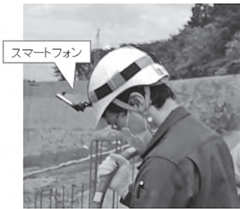
図-2 ウェアラブルカメラの設置状況
