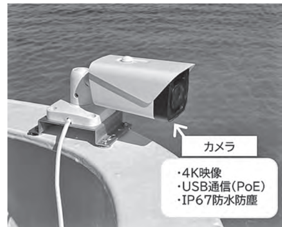
図一 13 カメラ設置状況
