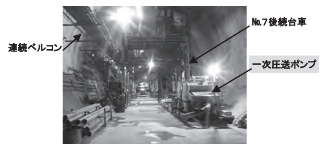
写真一六 一次圧送ポンプ
