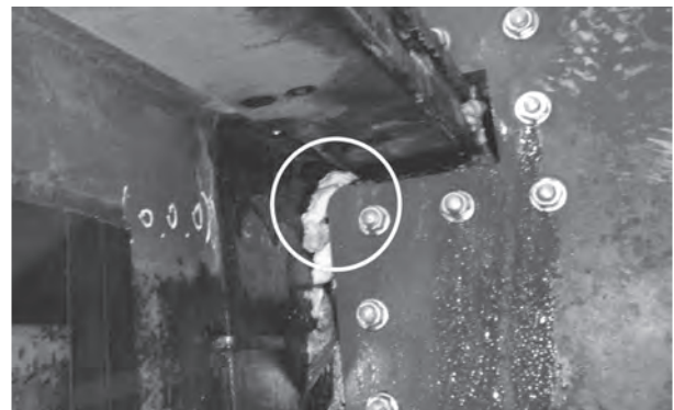
写真一1 下半部施工時の漏水状況
