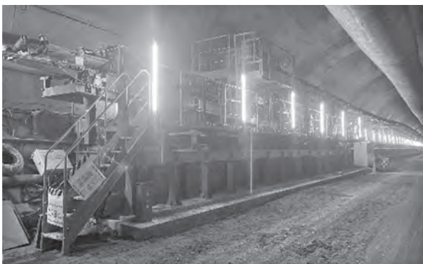
写真—2 中間ブースター
