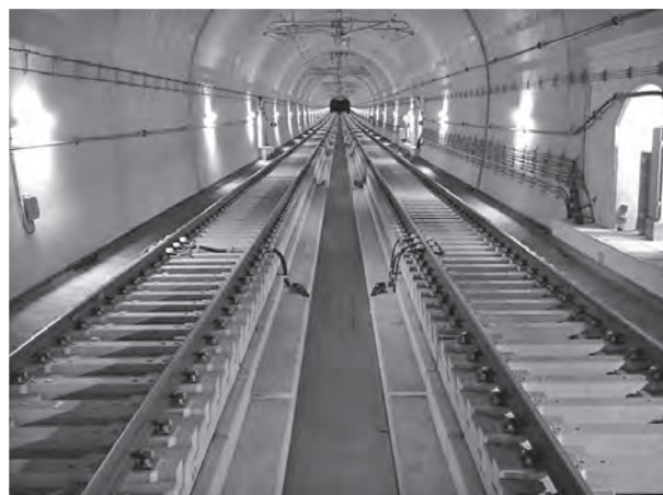
写真-4 弾直スラブ軌道
