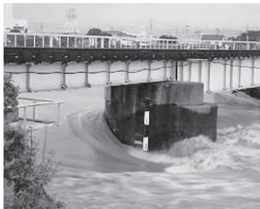
図-1 増水した河川に架かる橋梁
