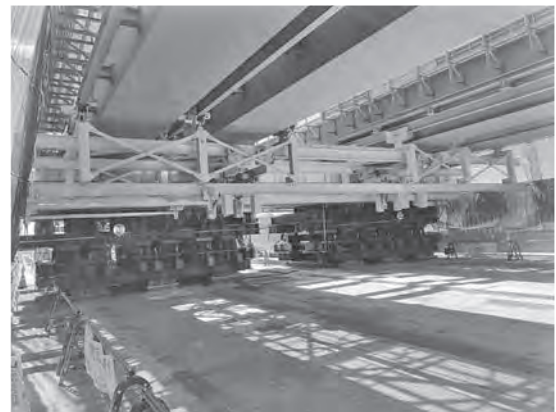
写真一5 サスペンションクレーン
