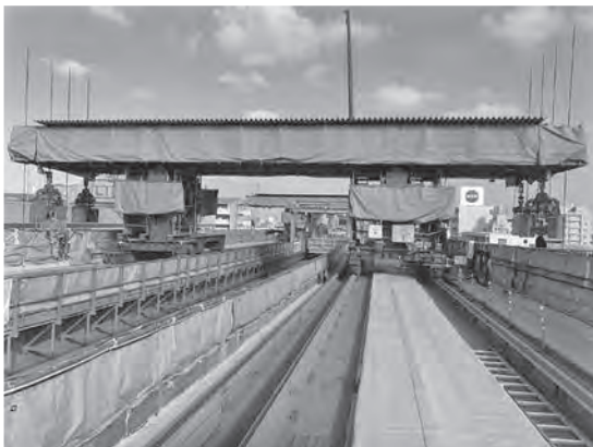
写真一3 移動台車上部フレーム及び走行装置
