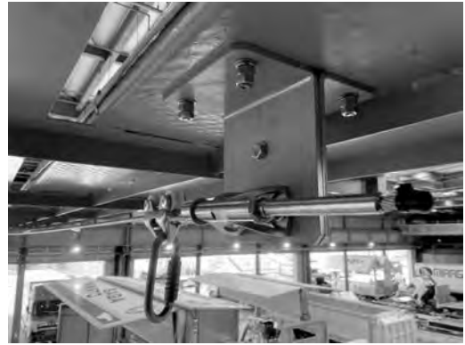
写真一八 屋内に設置した懸垂設置型システム（近接撮影）
