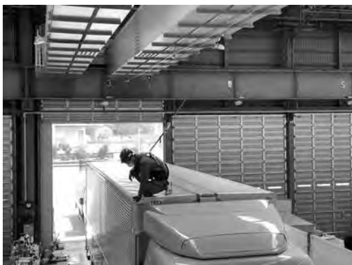
写真一七 倉庫の天井に設置した懸垂設置型システム
