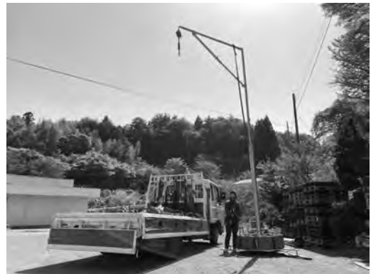
写真一九 屋外に設置した懸垂設置型システム
