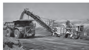
写真一23 Wirtgen 4200SM
