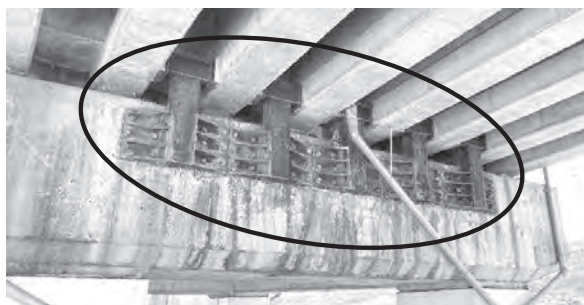
図一 7 PC 桁 変位制限装置
