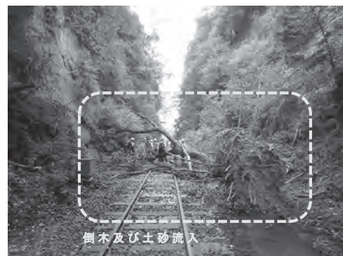
図-10 路盤部の被災状況(小湊鉄道)
