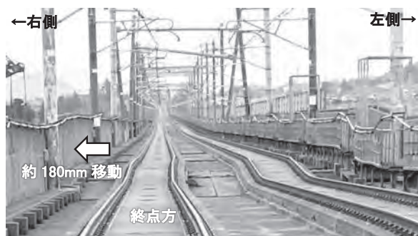
(c) 軌道損傷状況
