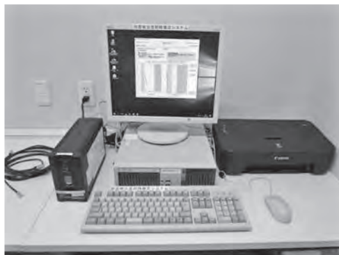
写真-2 建物内PCの設置
