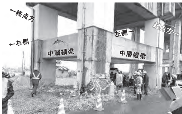
(b) 橋台損傷状況 (下層柱)
