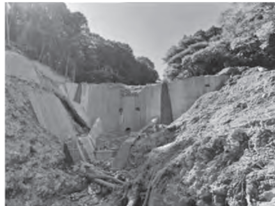
写真-1 被災状況 (既設砂防堰堤)
