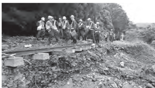
写真一三 調査の状況（路盤流出箇所）
