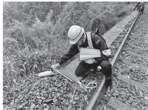
写真—2 路盤の流出状況の測定
